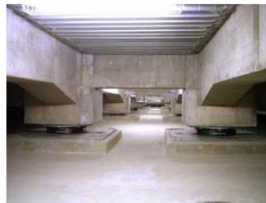
基礎ピット内の設置状況
